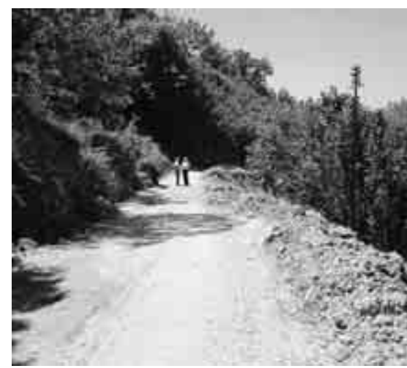
UNA DELLE STRADE DANNEGGiate DALLE PIOGGE INVERNALI
